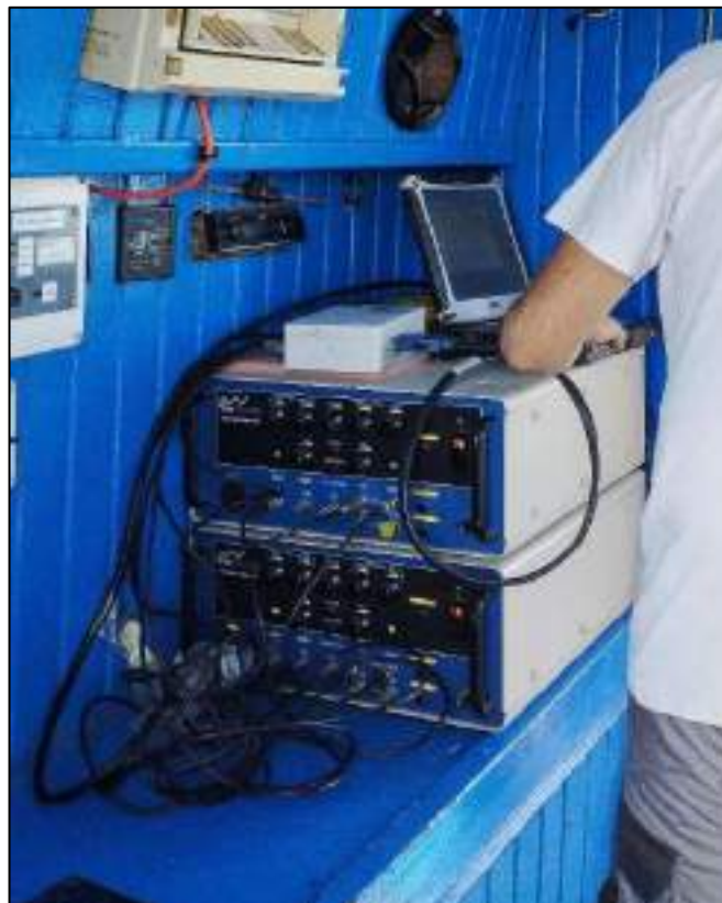
Figura 98. Equipos instalados en la cabina de la embarcación de trabajo
