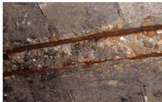
Fig. 11 Daños por proceso de corrosión del armado
