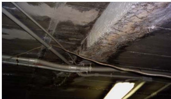
Fig. 09 Daños en sótano por falta de impermeabilidad
