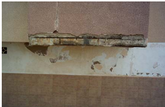
Fig. 05 Proceso de corrosión de armado
