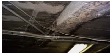
Fig. 26 Daños por corrosión del armado en un sótano
