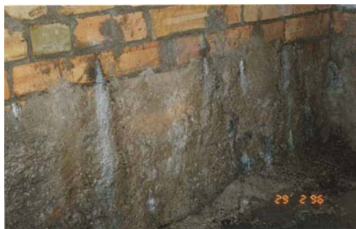
Fig. 03 Humedades de filtración
