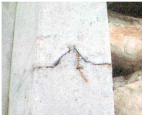
Fig. 26 Cinta mal colocada
